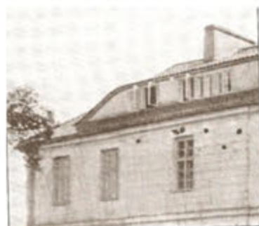
Kule armatnie w ścianie
